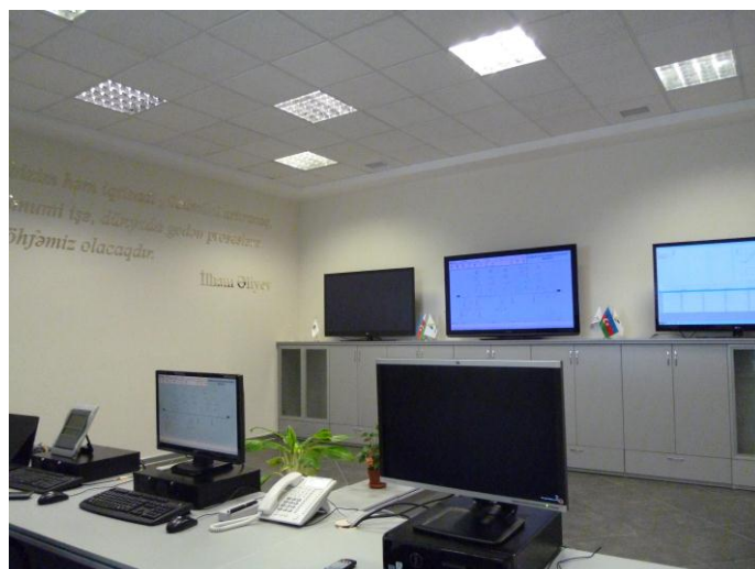
管理棟の中央コンピューター
