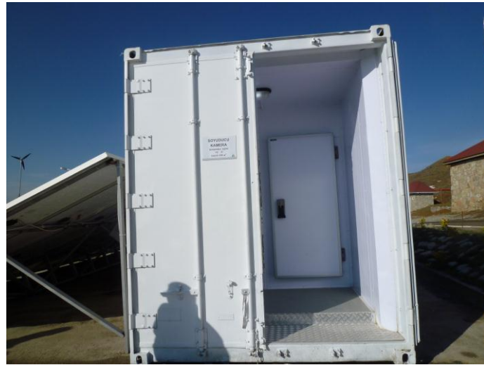
太陽光パネルを使った冷蔵コンテナ（農業用）
