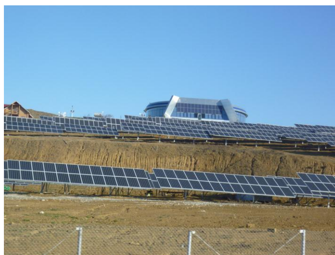
太陽光パネルゾーン
